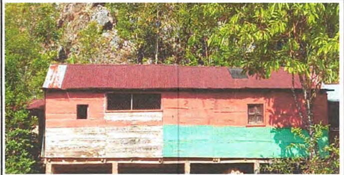
Foto 2: La cocina requiere reparacion en toda su estructura
